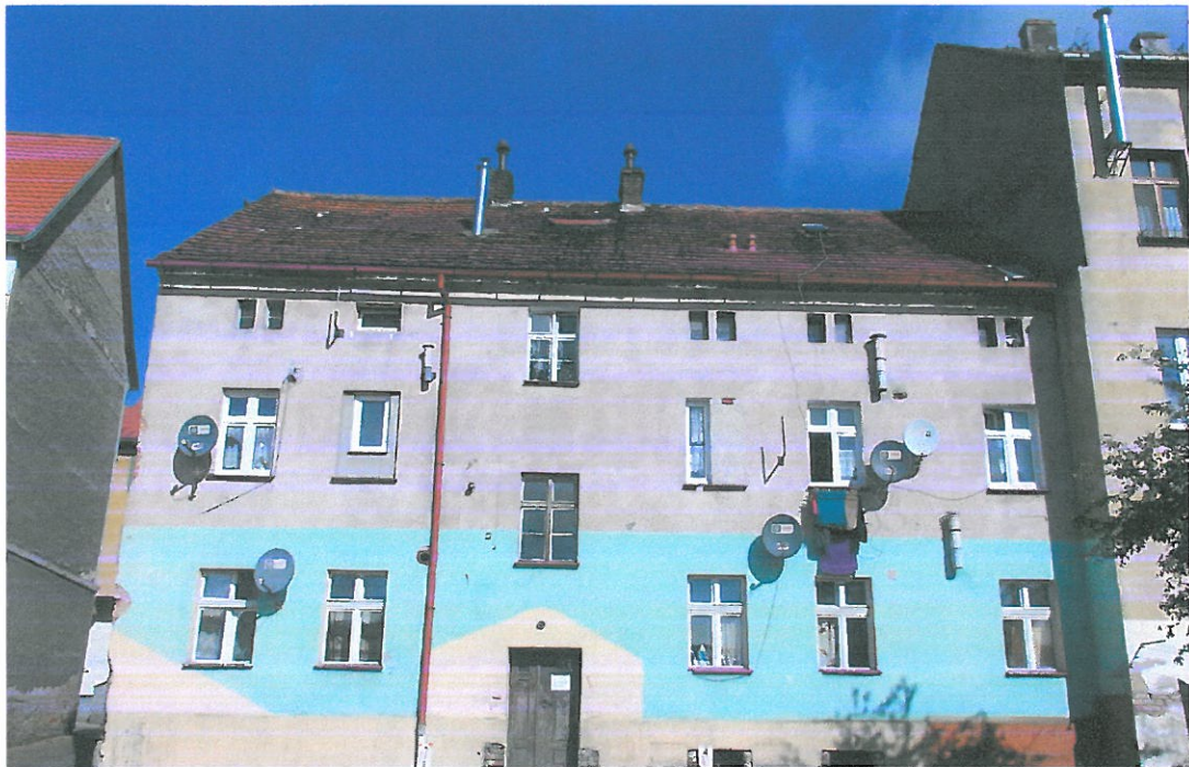
Zdjęcie nr 2 – Połączenie dachu południowego
