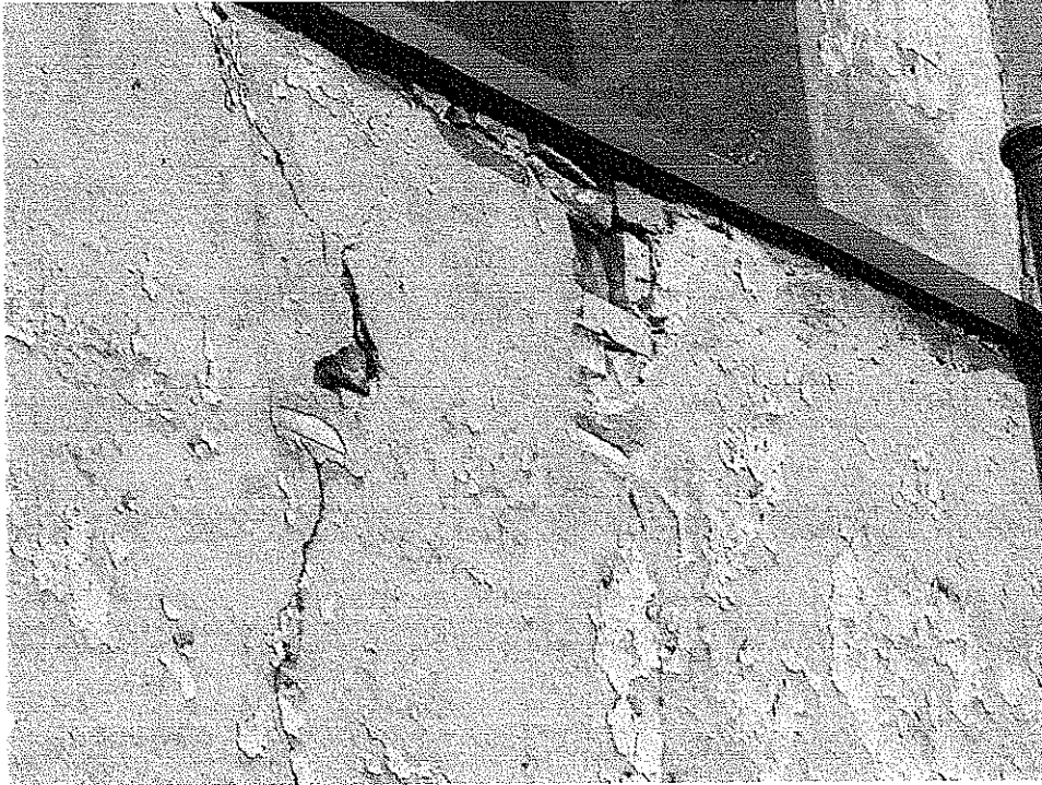
Zdjęcie nr 6 – Pęknięcia i rysy na elewacji bocznej
