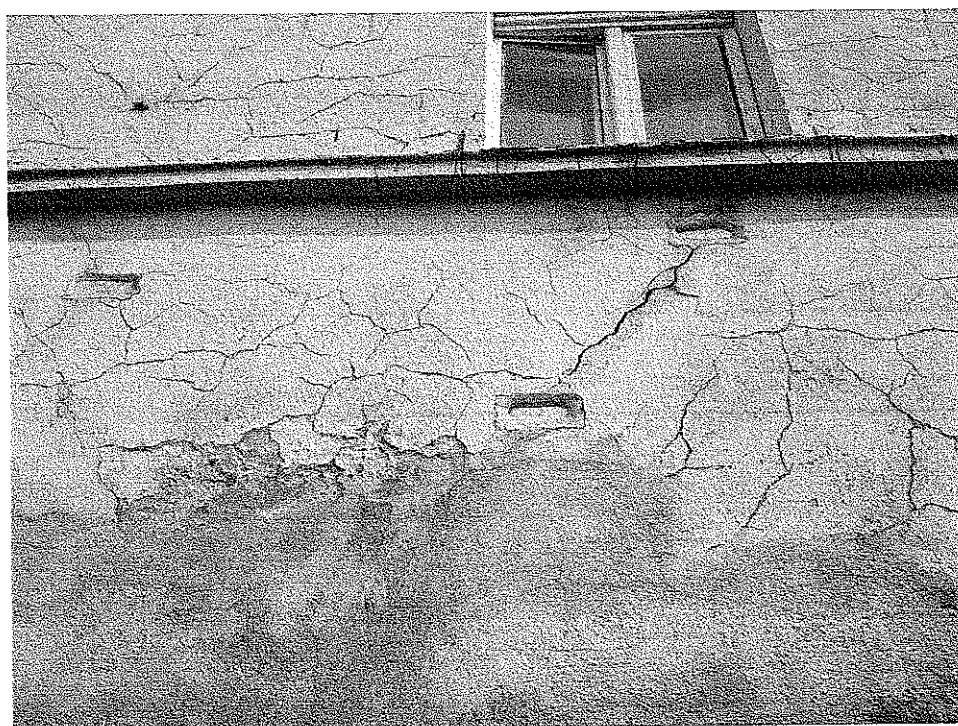
Zdjęcie nr 5 – Pęknięcia i rysy na elewacji frontowej
