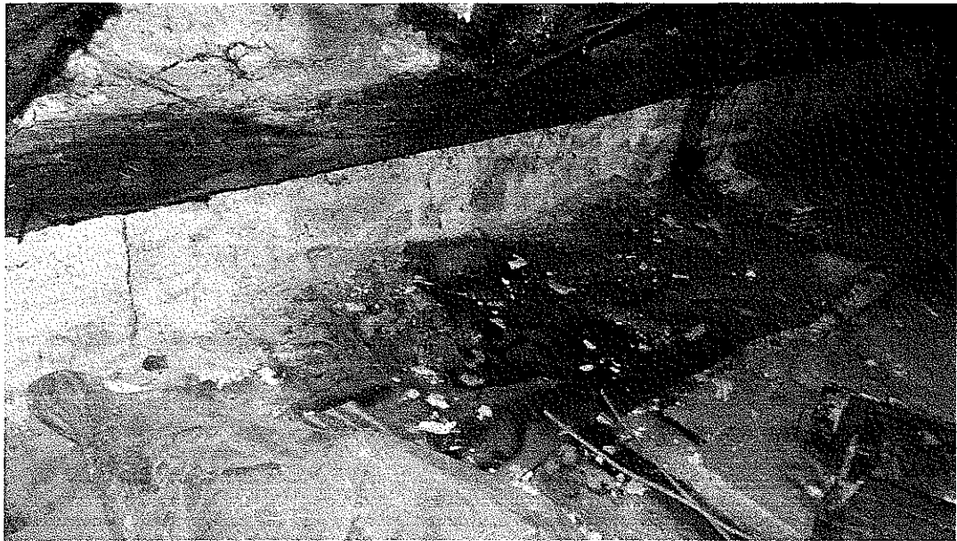
Zdjęcie nr 7 – Uszkodzona podłoga na II poziomie poddasza
