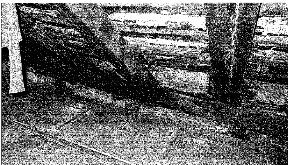
Zdjęcie nr 6 – Uszkodzony elementy drewniane na II poziomie poddasza
