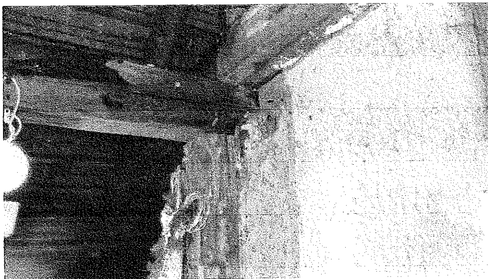
Zdjęcie nr 5 – Zawilgocone elementy drewniane
