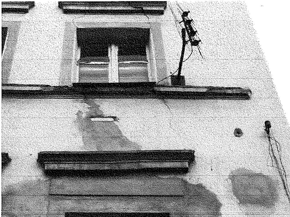
Zdjęcie nr 2 – Elewacja frontowa, uszkodzenia gzymsów pośrednich
