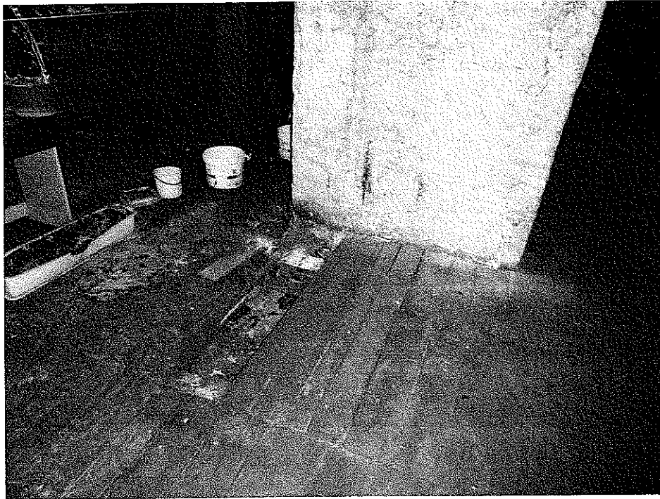
Zdjęcie nr 7 – Zniszczona podłoga
