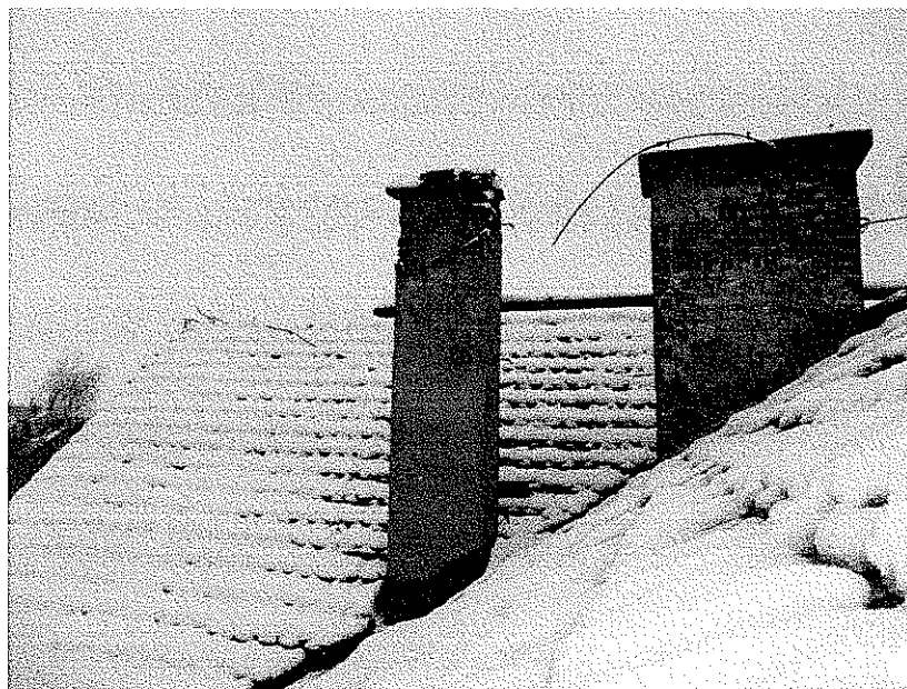
Zdjęcie nr 4 – Uszkodzone i pozbawione tynku kominy ponad dachem
