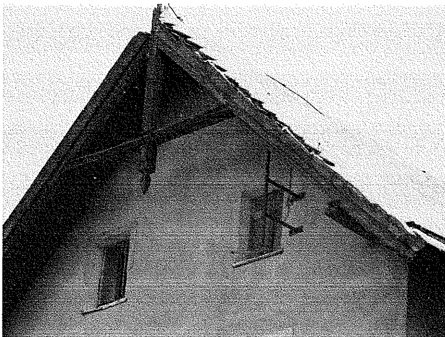
Zdjęcie nr 5 – Uszkodzone krokwie szczytowe
