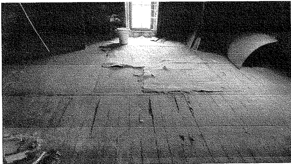
Zdjęcie nr 6 – Uszkodzona podłoga na poddasza
