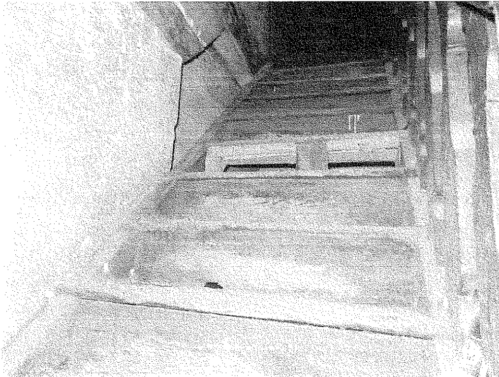
Zdjęcie nr 6 – uszkodzone schody na poddasze
