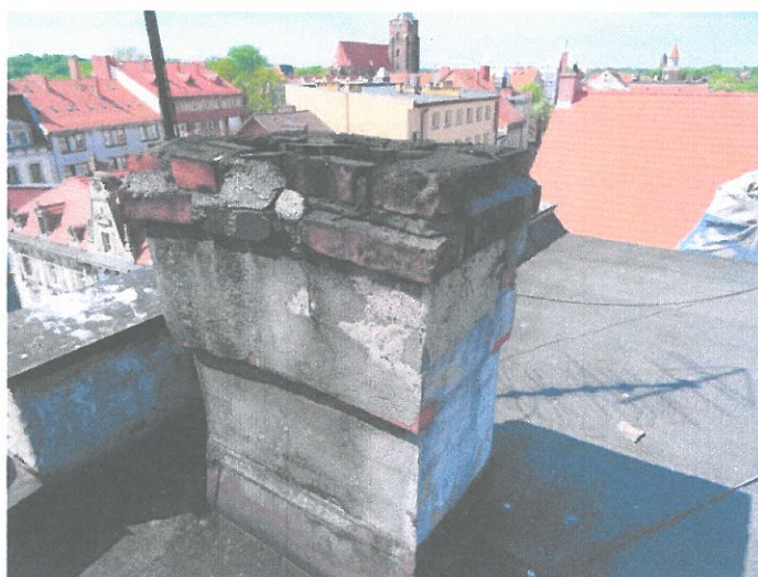
Uszkodzenia jednego z kominów ponad dachem.
