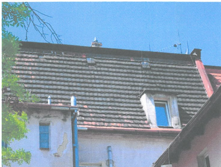
Pokrycie z dachówki od strony podwórza – widoczne ubytki i uszkodzenia dachówek.
