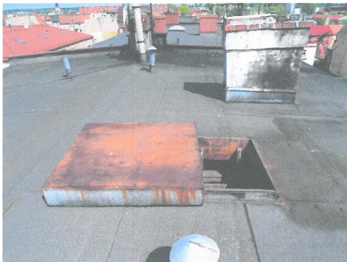
Zużycie eksploatacyjne, korozja pokrywy wylazu dachowego.
