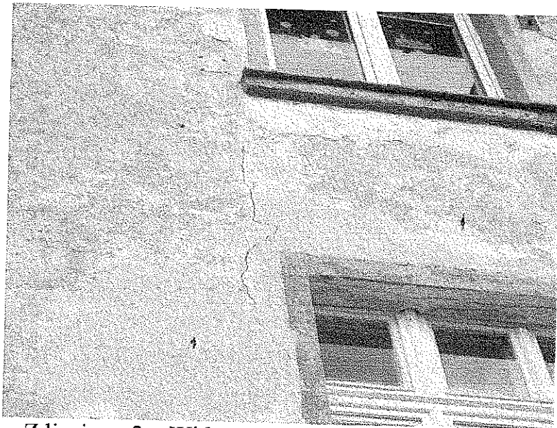
Zdjęcie nr 3 – Widoczne rysy i pęknięcia nadproży
