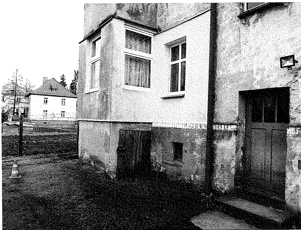
Zdjęcie nr 8 – Zawilgocone i odparzone tynki na cokole. Widoczny brak opaski przy budynku.
