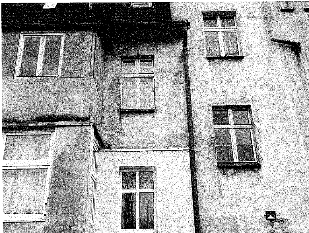
Zdjęcie nr 7 – Pęknięcia nadproży i rysy na elewacji tylnej
