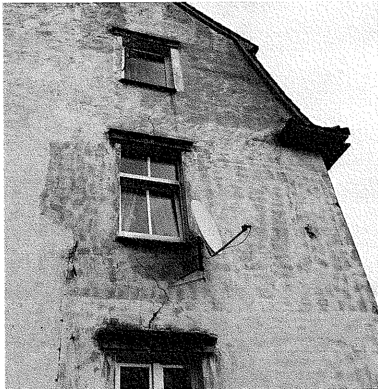
Zdjęcie nr 6 – Pęknięcia nadproży i rysy na elewacji bocznej
