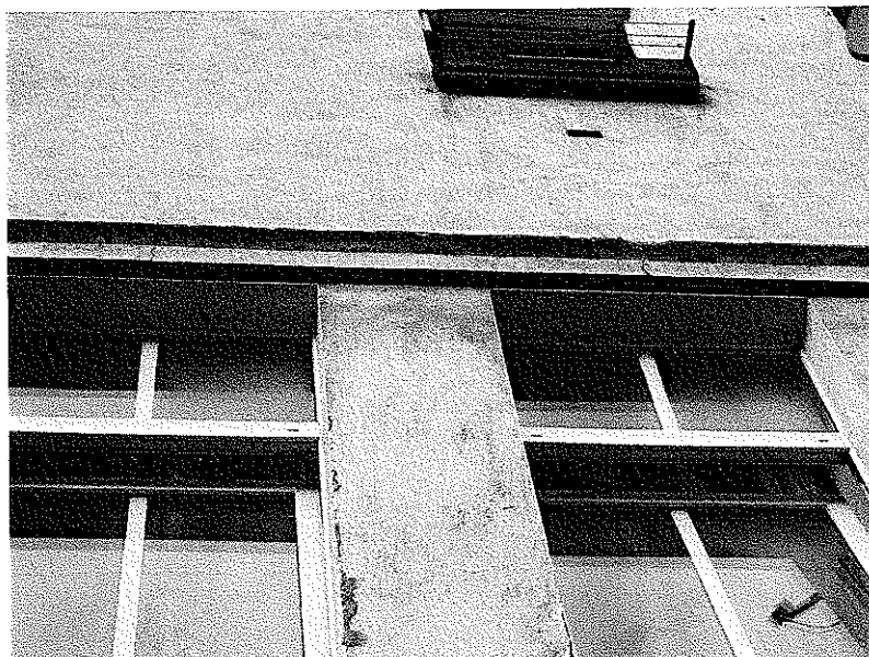
Zdjęcie nr 5 –Pęknięcia nadproży na elewacji frontowej
