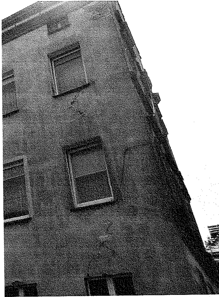
Zdjęcie nr 5 – Pęknięcia elewacji północnej
