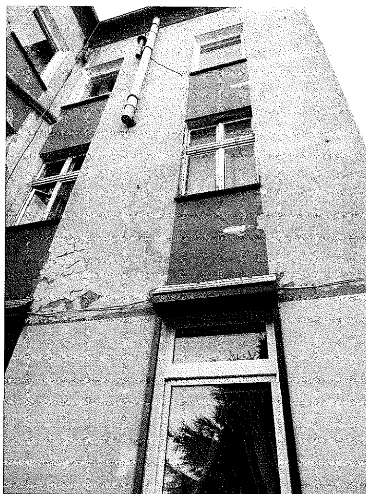
Zdjęcie nr 5 – Elewacja tylna – widoczne pęknięcia
